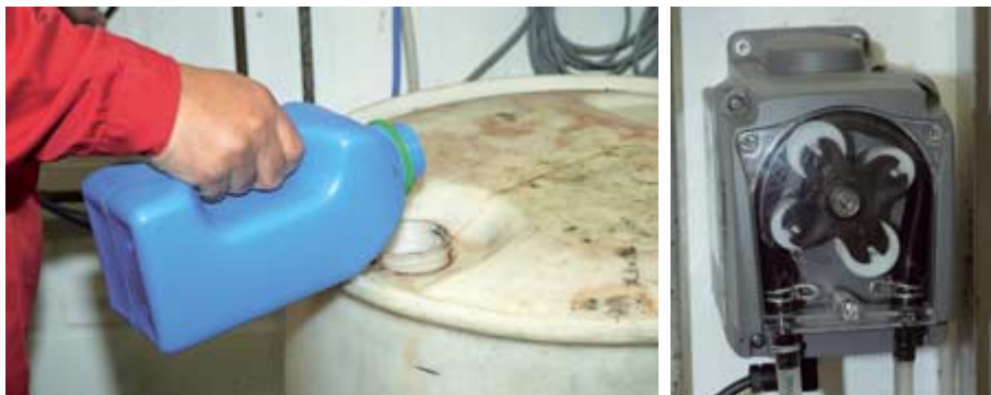
Das Pflegemittel für die Klauen ist von Hand in einem 200 Liter großen Tank anzumischen. Ausdosiert wird über eine 24-Volt-Schlauchpumpe.
